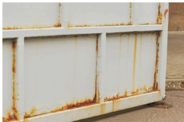
Das Eingangstor zeigt deutliche Rostspuren.
