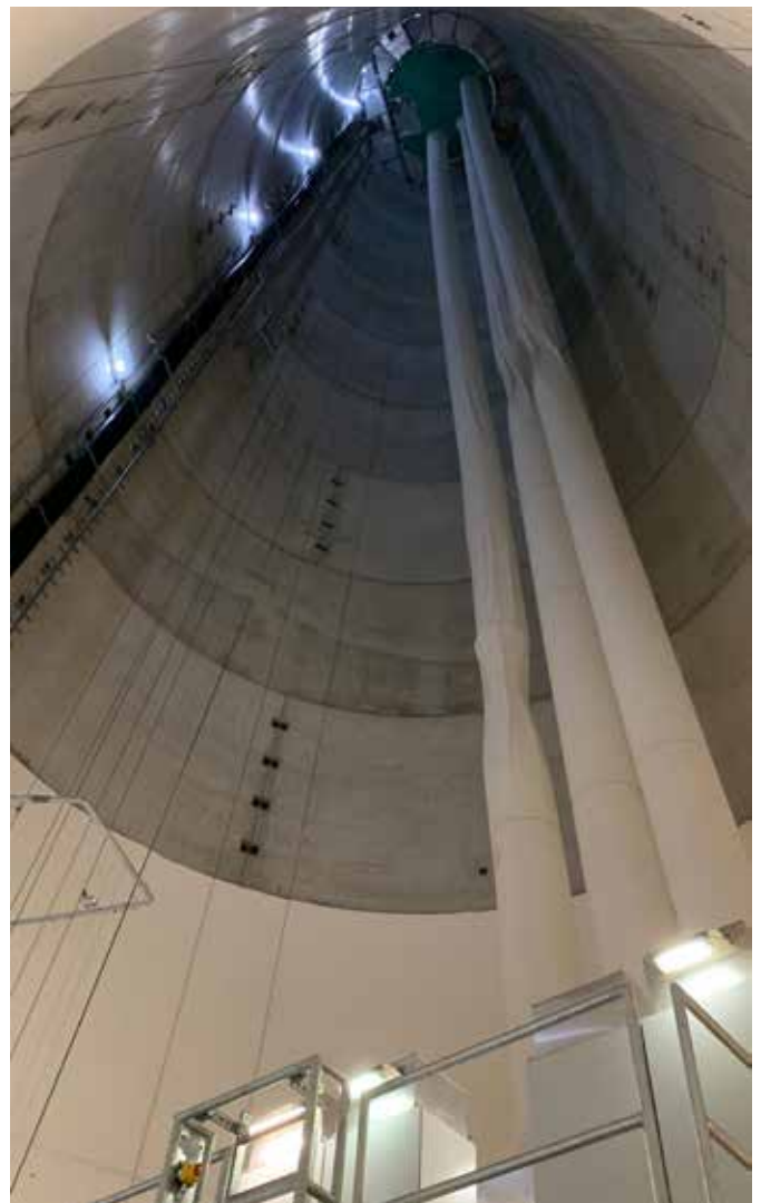
Unterer Innenraum einer WKA
