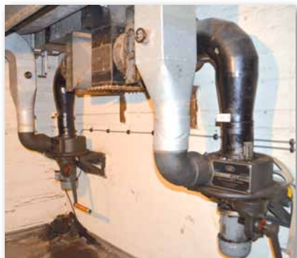
Noch funktionstüchtig: die originale Lüftungsanlage
