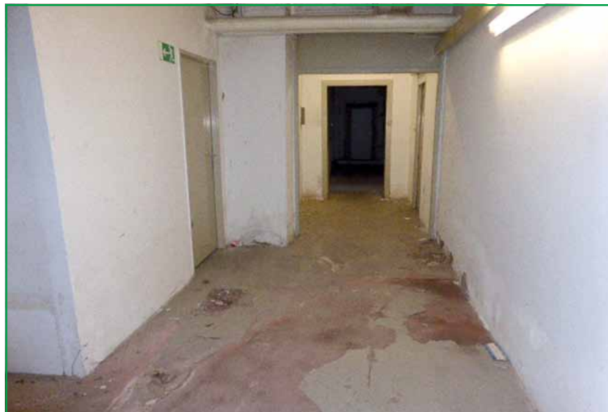
Boden im Keller Berliner Straße, Boden in Auflösung, sichtbare Löcher
