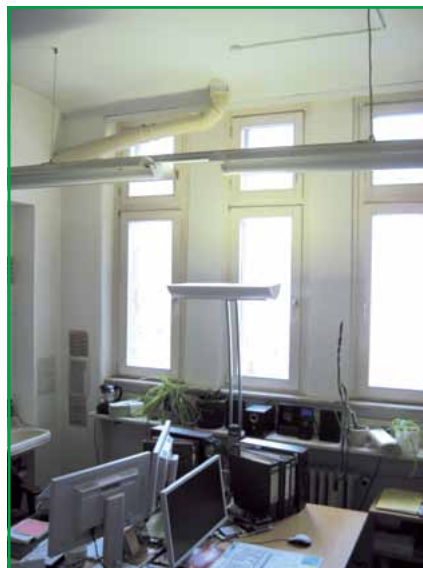
Arbeitszimmer Berliner Straße mit Abwasserrohr an der Decke
