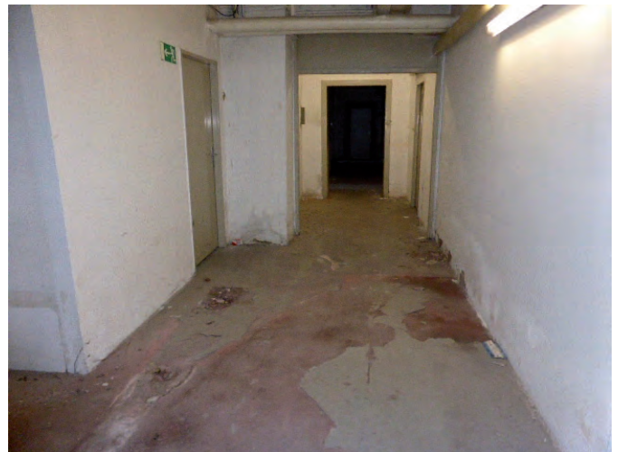
Boden im Keller Berliner Straße, Boden in Auflösung, sichtbare Löcher.
