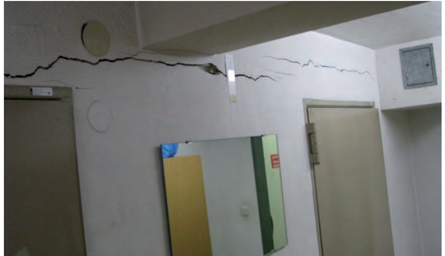
Deutliche Risse im Polizeipräsidium Offenbach im Bereich der Umkleieräume im Keller.
