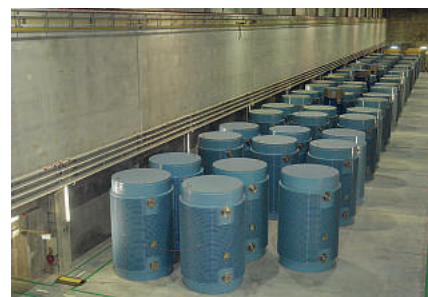
Transportbehälterlager im ZLN mit 65 Castoren Foto: EWN Lubmin
