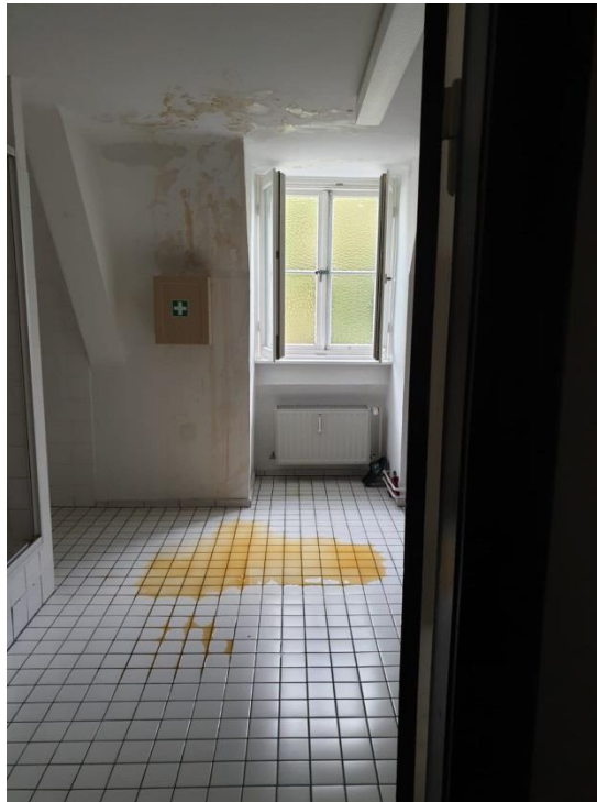
Wasserschaden in der Pst. Neumünster West
