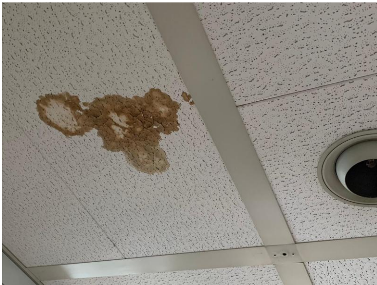
Feuchte Deckenplatten in der PI Lebach
