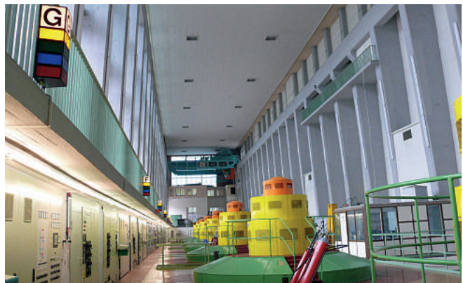
In der Maschinenhalle des Pumpspeicherwerks Foto: Blumenstein
