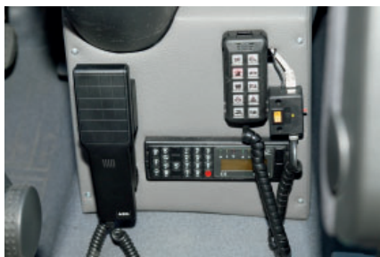
Die Technik ist in leicht zugänglichen Zwischenräumen untergebracht.
