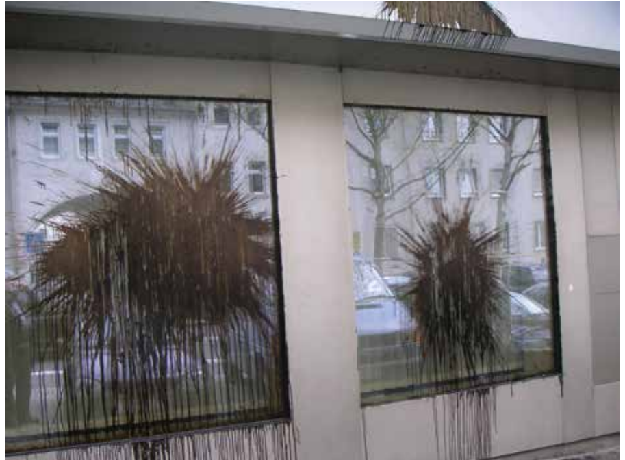
Beschädigte Fenster und Fassade
